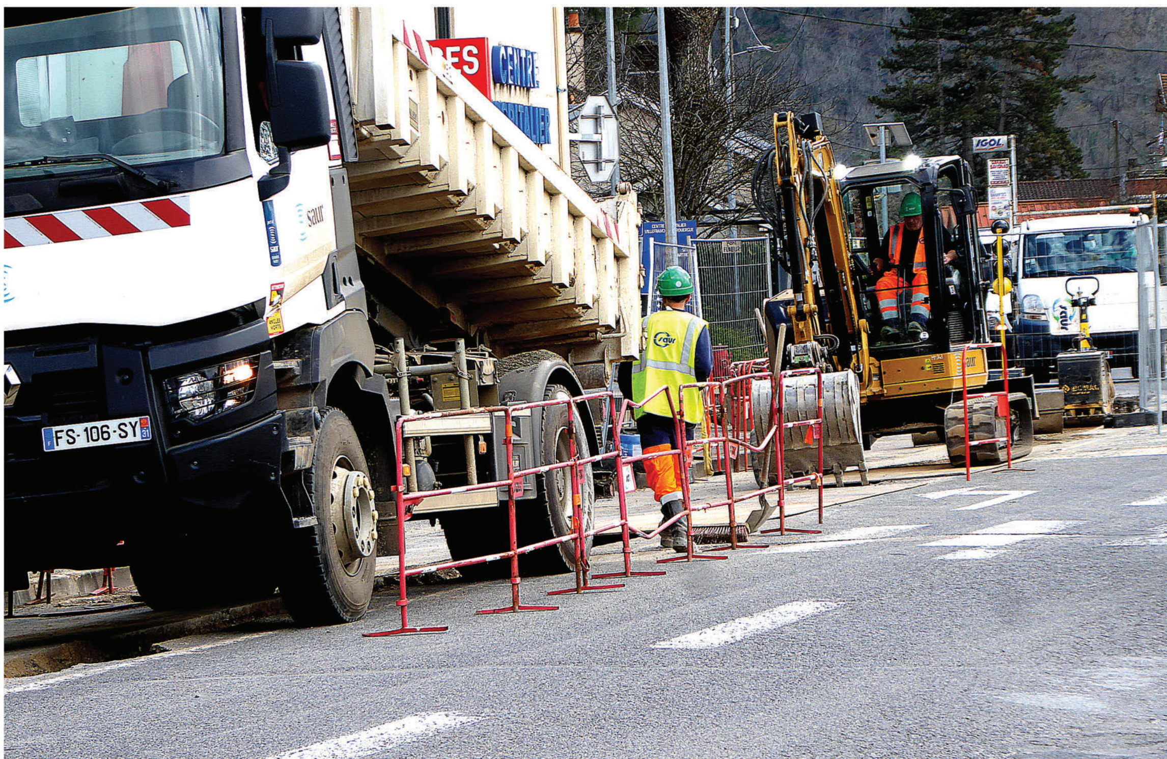
Les chantiers importants se poursuivent comme ici avenue Caylet sur le réseau d'eau.
